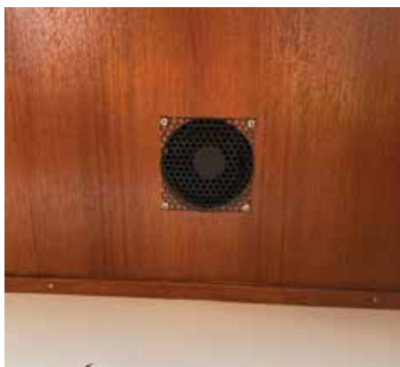
Grill for ventilation fan
